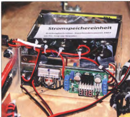
Bild 3: Herzstück der Stromspeichereinheit sind zwölf Supercaps, die zusammenschaltet 150 F ergeben. An der Frontseite sind Gleichrichterbrücke und Spannungswandler befestigt. Fotos: DK4MY
