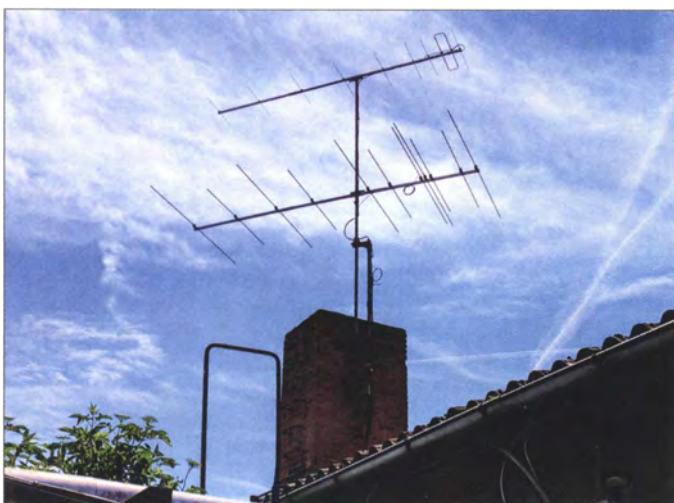
Bild 1: Die Dualband-Yagi für das 6-m- und das 4-m-Band bei DH8BQA ist in der Mitte des Mastes gut zu erkennen.
